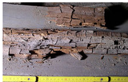
Schadbild einer durch den Echten Hausschwamm verursachten Braunfäule
