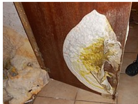
Frisches Luftmycel des Echten Hausschwamms an einer lange nicht geöffneten Kellertür
