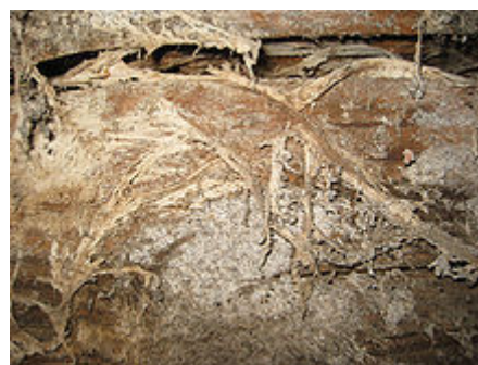
Holzbalken mit intensivem Befall (Mycelstränge deutlich sichtbar)
